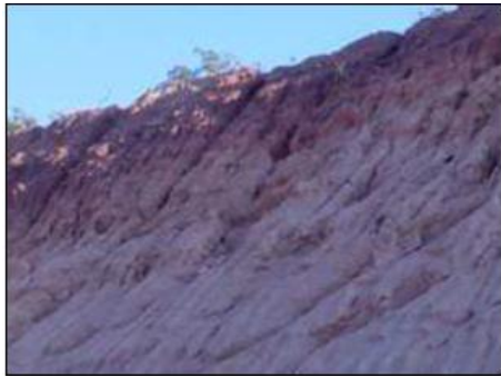
(1) Erosión en taludes
