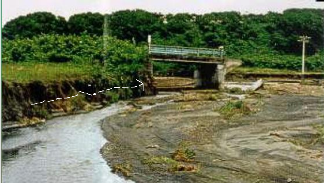
5) Erosión del talud izquierdo (sin proteger) cuya afectación avanzará hacia el estribo del puente.
